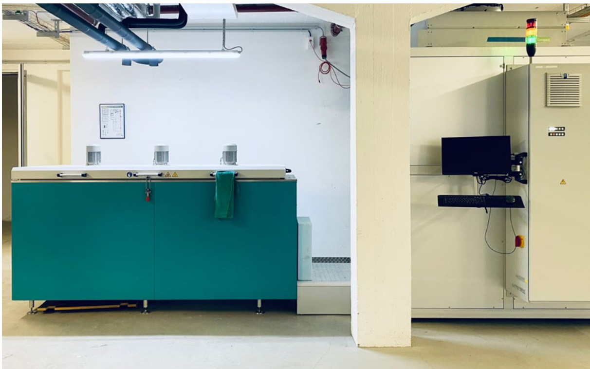
Eine der neuen Anlagen für Frost-Tau-Wechselversuche und Druckprüfungen nach DIN EN 12091
