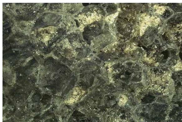
Abb. 8: Schaumglas mit oberflächlichen Strukturschäden durch Frost-Tau-Wechsel
