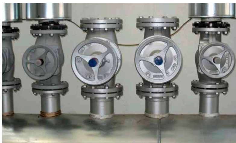
Abb. 2: Ventilgruppe als Komponente von technischen Dämmsystemen
