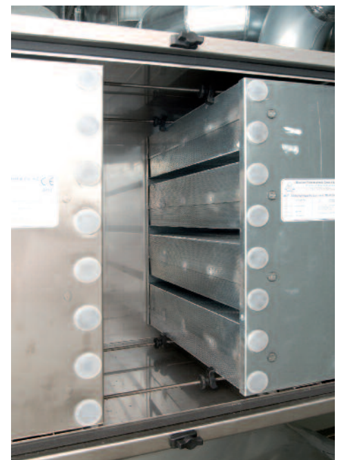
Zuluftreinigung mit Aktivkohlezellen
