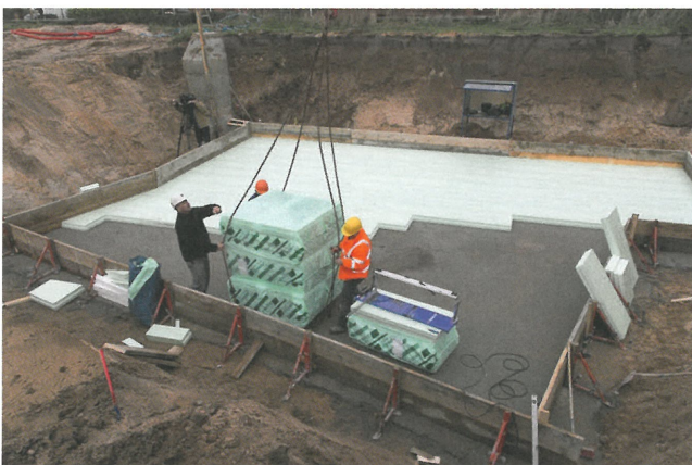
Bild 13. Verlegung einer XPS-Dämmung unter der lastabtragenden Gründungsplatte auf einer Sauberkeitsschicht (Foto: BASF SE)
