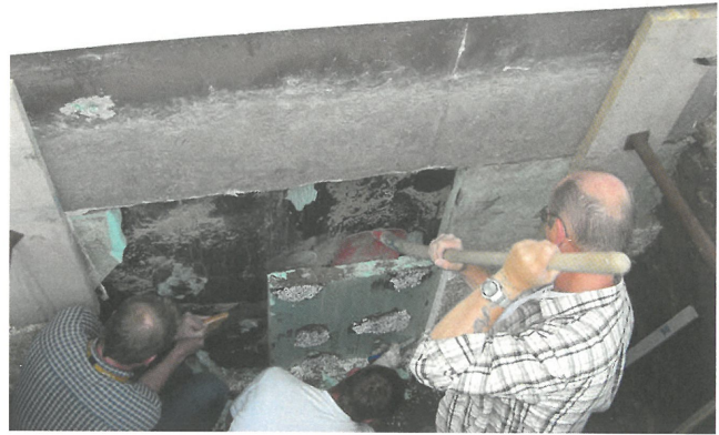
Bild 6. Ausbau einer Kellerwanddämmung aus XPS nach 29 Jahren Einbauzeit aus einem Privathaus in Ladenburg (Foto: FIW München)
